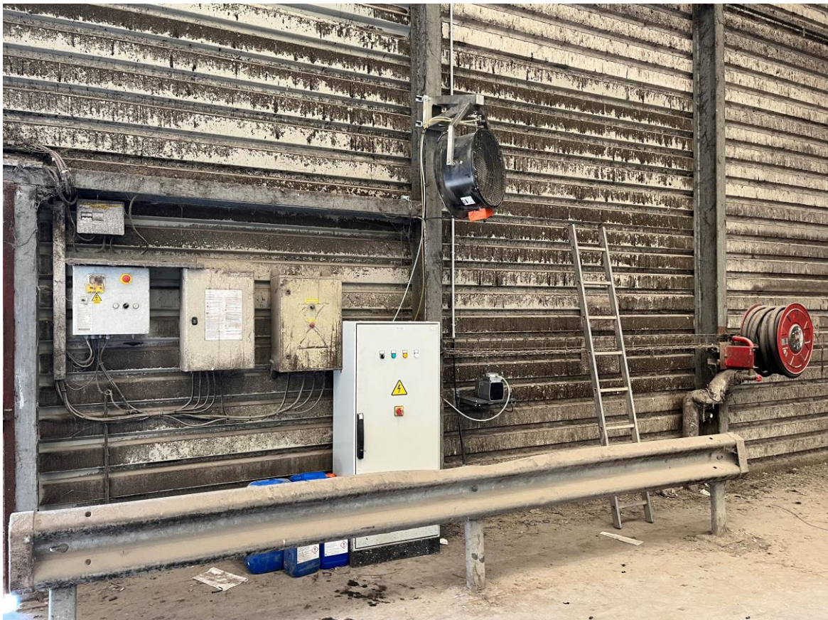
Armoire VS200 avec 1 buse et 1 ventilateur 6 700 m 3 /h
